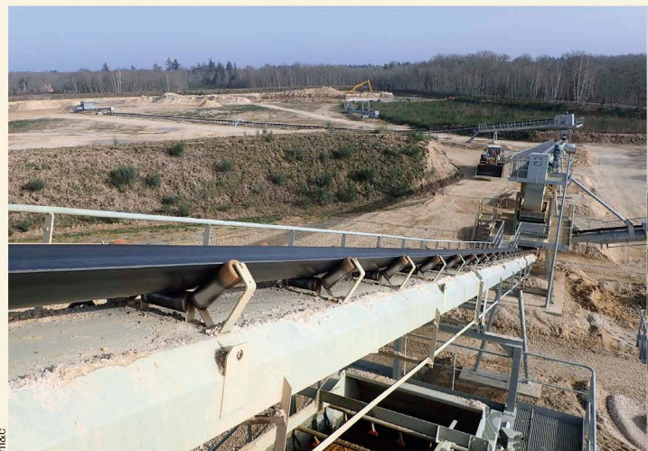
Vers la zone d'extraction : une pelle à bras long extrait le tout-venant (à droite) qui est mis en égouttage et repris pour alimenter l'installation via la trémie (sur la gauche).
